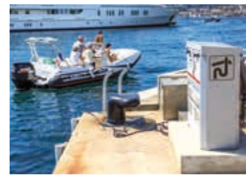
Une station de pompage des eaux usées unique en Méditerranée, est à disposition des plaisanciers.
