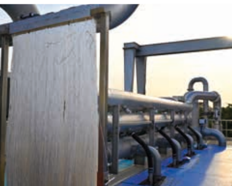
La station d'épuration Aquaviva est capable de purifier l'eau usée (les eaux des égouts) grâce à une technologie de filtration membranaire et d'ultraviolets.
