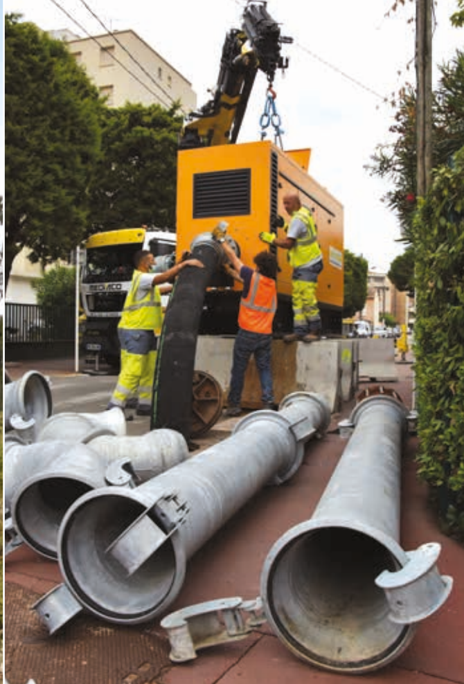
Sur une idée de l'Agglomération Cannes Lérins, un dispositif de pompage d'eau de pluie destiné à être activé en cas de fortes intempéries a été expérimenté en septembre rue de Cannes, à La Bocca. Il a par la suite été déployé à plusieurs reprises, comme le 2 octobre dernier.
