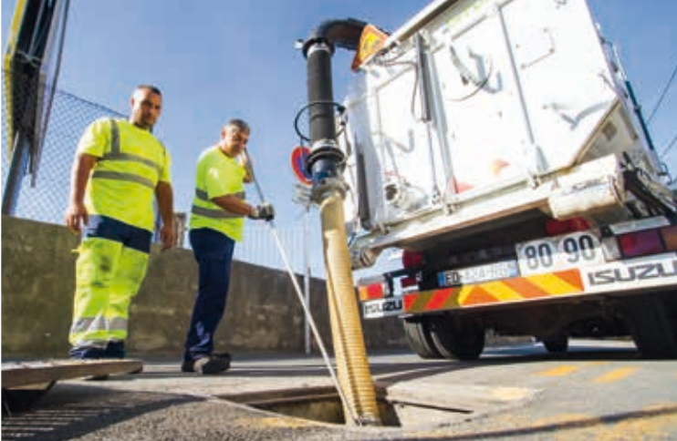
La Mairie a repris en régie les prestations de curage des avaloirs dans certains quartiers de la ville plus sensibles aux inondations et a fait l'acquisition d'une cureuse mécanique pour optimiser les opérations de nettoyage.
