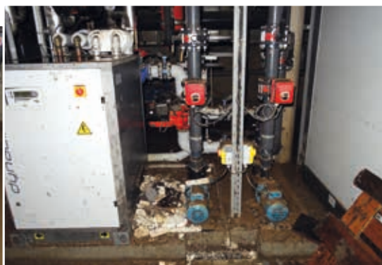
Le chauffage solaire a également subi des dégâts très importants.
