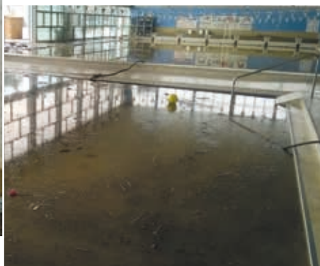
La boue a infiltré les installations techniques mais aussi les bassins.
