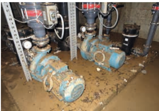
Les pompes assurant la filtration du bassin de 25 mètres ont été totalement ravagées.
