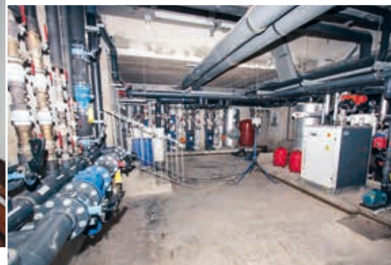
Aujourd'hui nettoyées, les installations techniques de la piscine Grand Bleu nécessitent de grosses réparations. Outre les évaluations des services municipaux, les travaux estimés reposent également sur des expertises externes pour garantir la qualité des opérations de remise en état.
