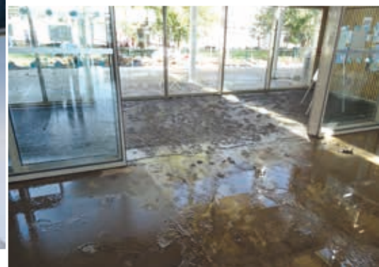
Au lendemain des intempéries, l'eau et la boue ont infiltré les locaux, nettoyés par les agents de la direction des sports.
