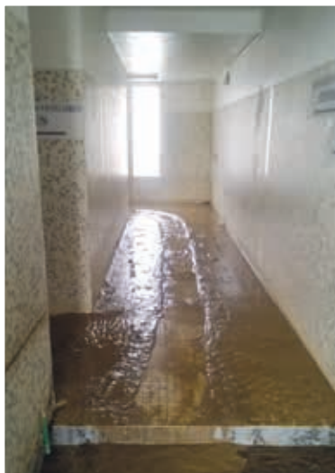
La piscine Pierre de Coubertin a été gravement touchée par les intempéries.
