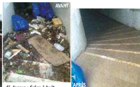
Ci-dessus : Grâce à huit bénévoles, encadrés de deux agents de la Direction prévention et tri des déchets et deux agents de la Propreté urbaine, le passage souterrain de la gare inondé a pu être nettoyé une fois asséché.
