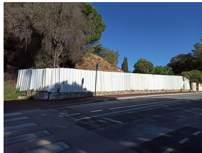
Espace en chantier, avec vue sur les arbres du camping en second plan / Source : EVEN-Avril 2021
