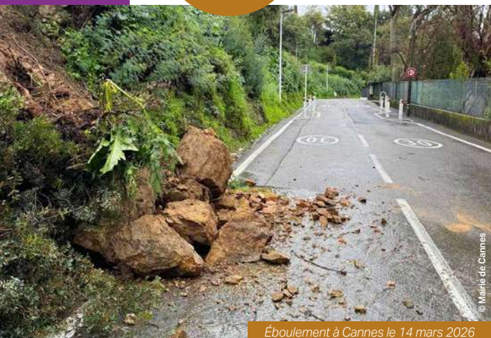
Éboulement à Cannes le 14 mars 2026
